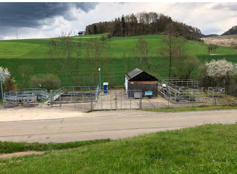
Kleine Kläranlagen – hier Bännwil – leiten das gereinigte Wasser wieder im Oberlauf des Bachs ein.
